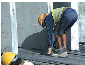
Fig. 2 Inclinación de espalda
